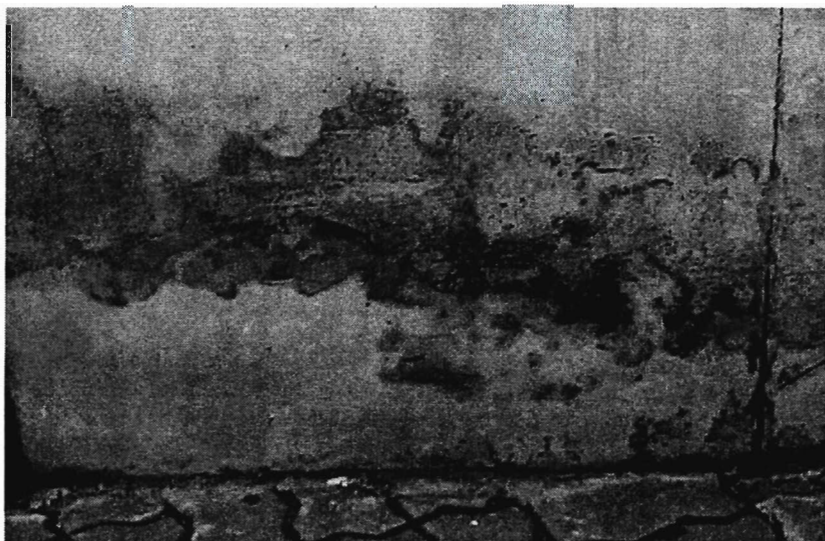
Fot. 1. Widok wykwitów solnych na powierzchni okładzin w Pałacyku Gościennym
