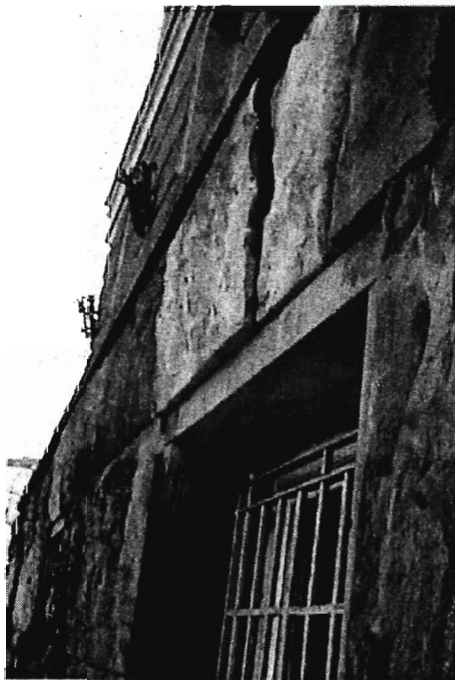
Fot. 4. Pęknięta płyta okładzinowa nad oknem w budynku Uniwersytetu w Białymstoku (Plac Uniwersytecki)
